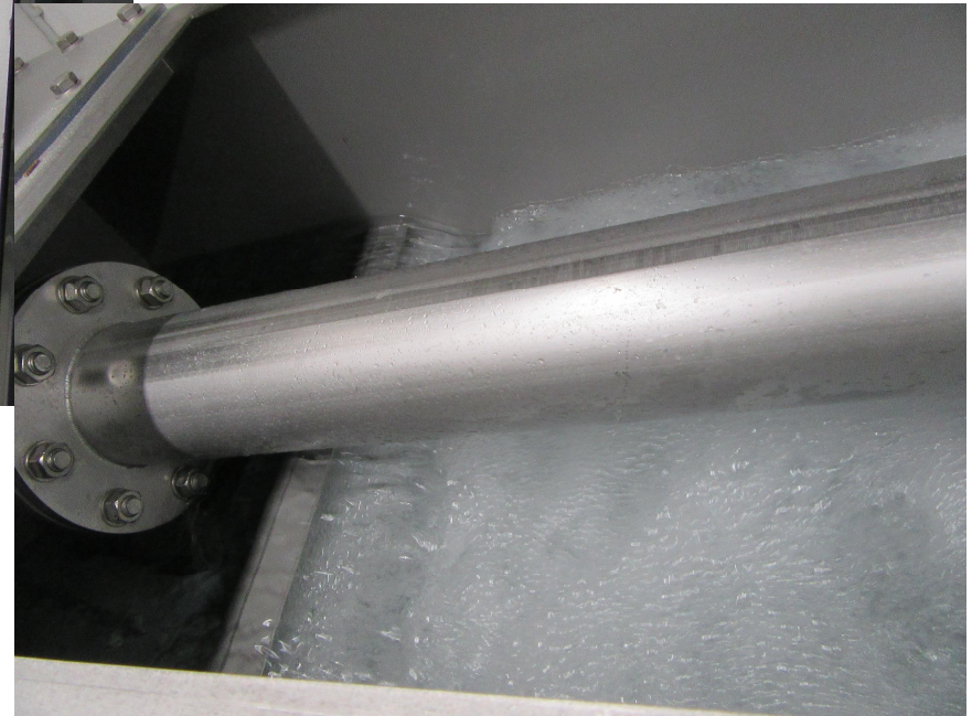
Flachbettbelüfter Wasserwerk Eschau
