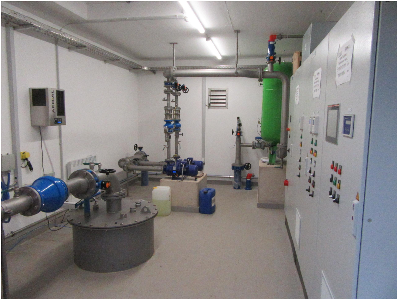
Tiefbrunnen „Quelle“ Eschau - Innenansicht
